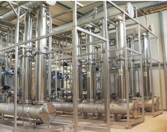
Ultrafiltrations-Anlage Vinnolit Knapsack
